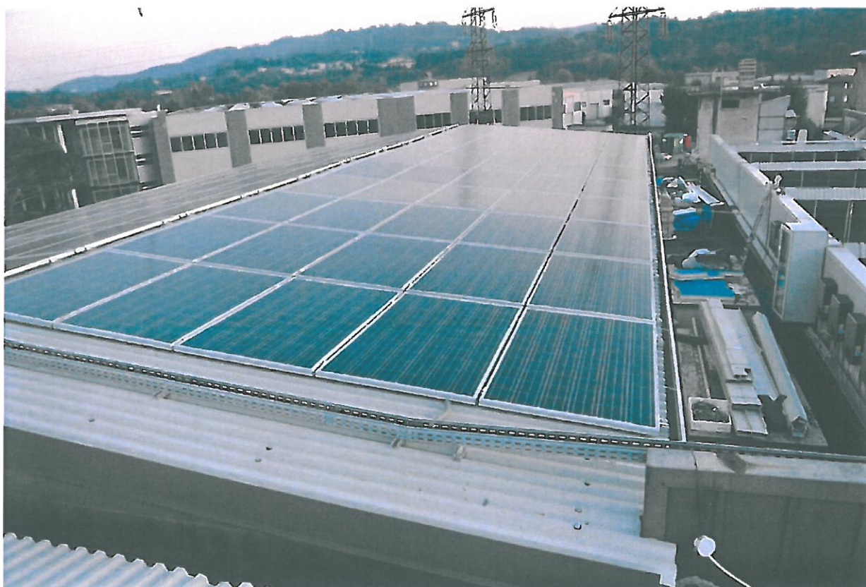
IMPIANTO FOTOVOLTAICO SU TETTO MENSA
