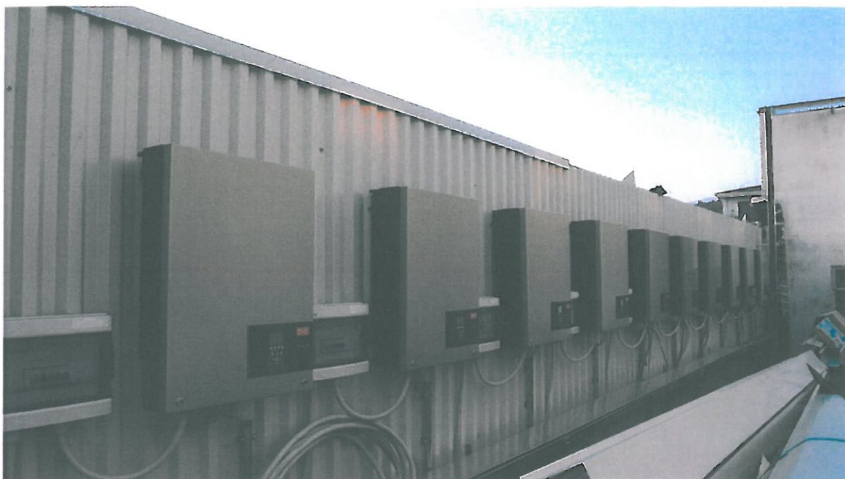
INVERTERS IMPIANTO FOTOVOLTAICO
